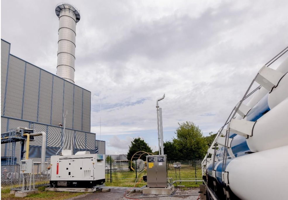
DEUTZ H2-Genset auf dem Gelände der RheinEnergie Köln Bildnachweis: RheinEnergie AG
